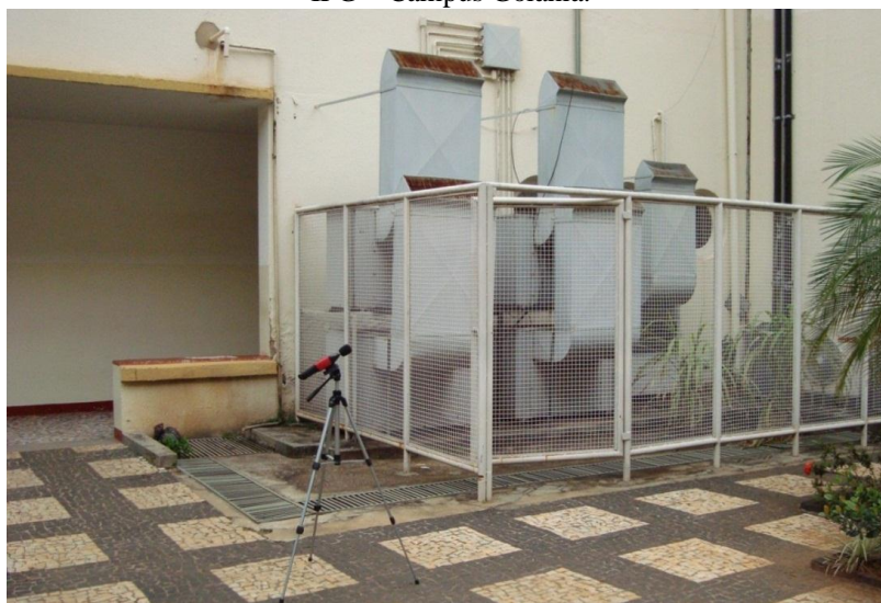
Figura 7 - Sistema de climatização do teatro localizado no pátio interno, entre o bloco 100 e a biblioteca do IFG – Campus Goiânia.
